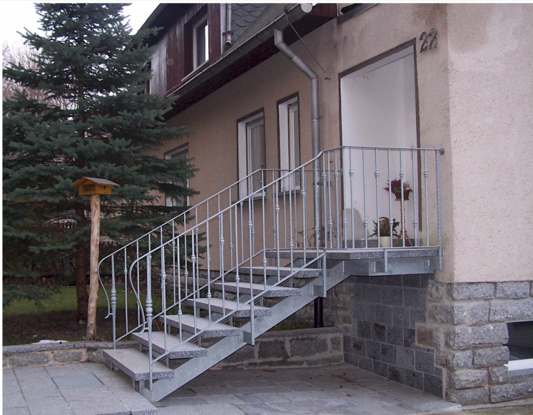
08 Gerade U-Profil-Wangentreppe mit Austrittspodest, aufgesattelte Natursteinstufen, schmiedeeisernes Geländer feuerverzinkt
